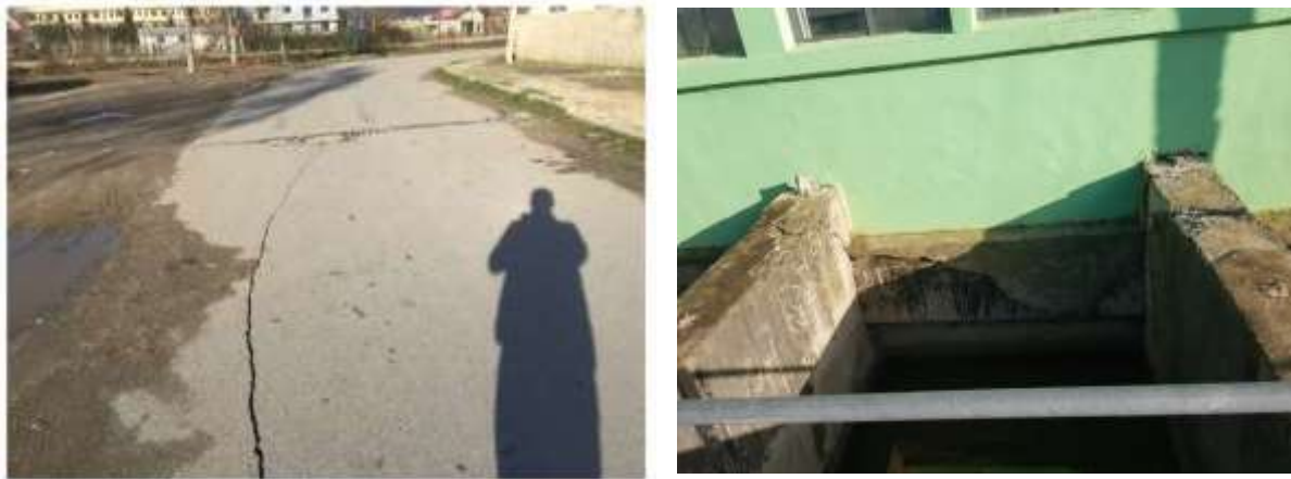
Figura 7 & 8 fenomeni i subsidencës i vërejtur në Hidrovorin e Hamallaj
