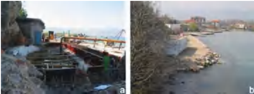
Fig. 5 Burimi i Tushemishtit: a Perdja nëntokësore ujizoluese gjatë ndërtimit; b Pamja përfundimtare e veprës ujëmarrëse
